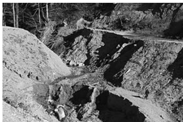
Рис. 5. Разрушенная селевыми потоками автомобильная дорога в верховьях р. Пиехи. Фото Д. Ю. Шулякова. Сентябрь 2011 г.
