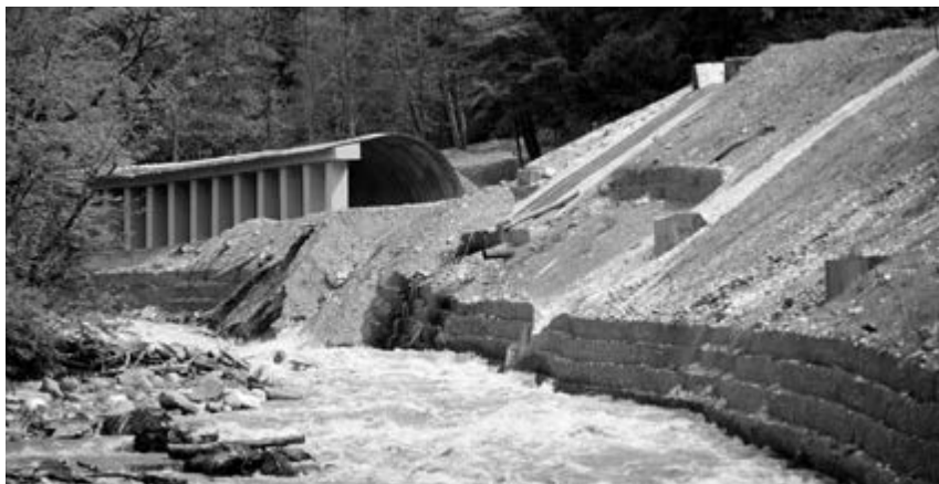
Рис. 3. Селезащитная галерея на дороге № 23 и прорыв селевых масс через селезащитные сооружения в русло р. Мзымты, фото автора. Май 2015 г.
