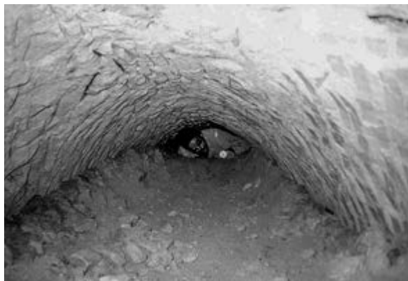
Рис. 6. Дренажная галерея (№ 5), засыпанная отвалом грунта
